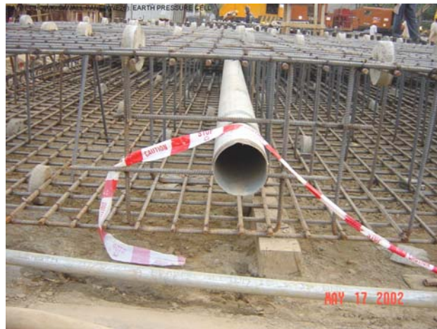
Photo 3. GI casing welded to a reinforcement cage of a diaphragm (D) wall
